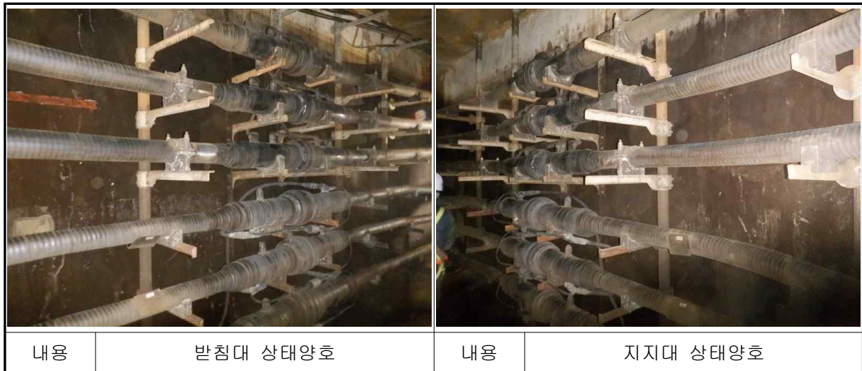
【사진 14.56】 부속 및 부대설비 현황
