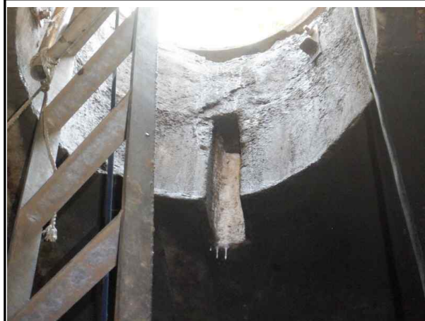
내용 상부슬래브 백태
