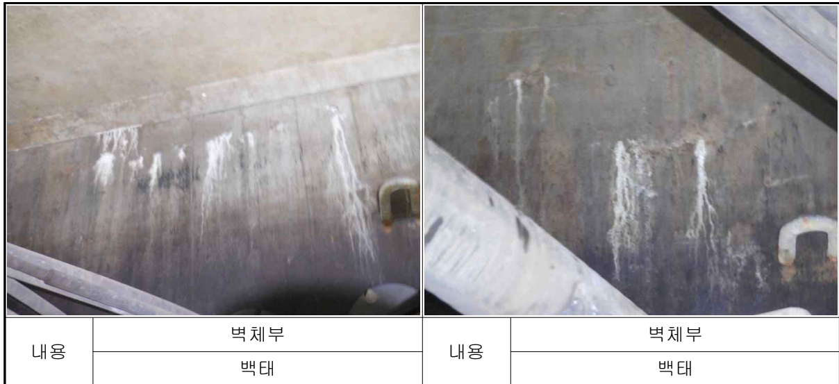
【사진 14.54】 맨홀 내부 주요 손상
