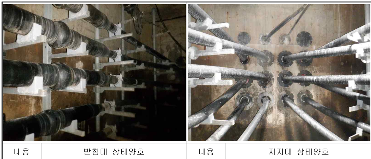
【사진 14.36】 부속 및 부대설비 현황
