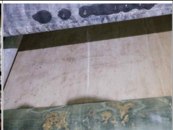
내용 벽체 균열부백태
