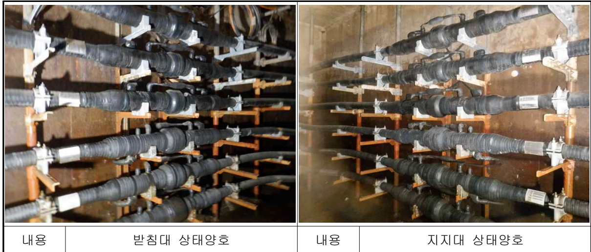
【사진 14.20】 부속 및 부대설비 현황
