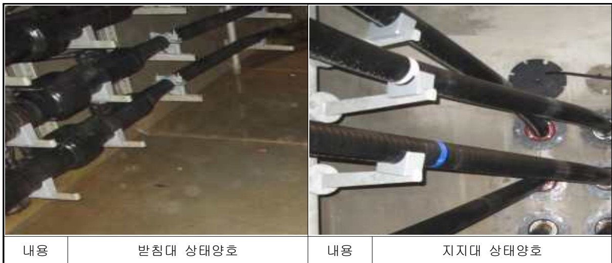
【사진 14.16】 부속 및 부대설비 현황
