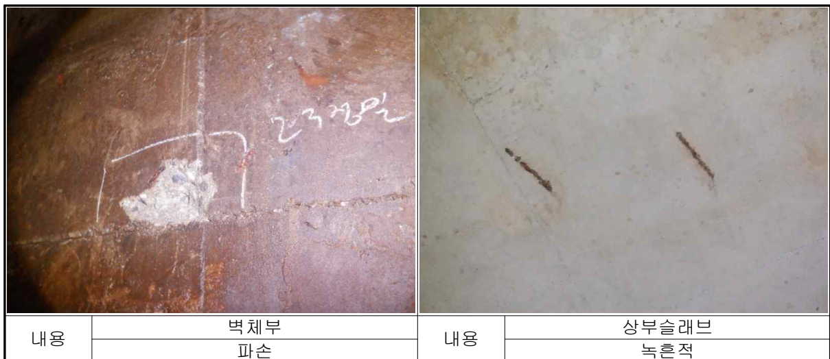
【사진 14.22】 맨홀 내부 주요 손상
