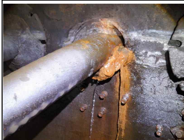
내용 관로구 관로구누수, 파손
