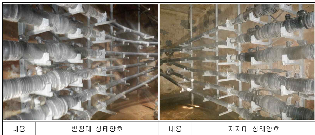
【사진 14.28】 부속 및 부대설비 현황
