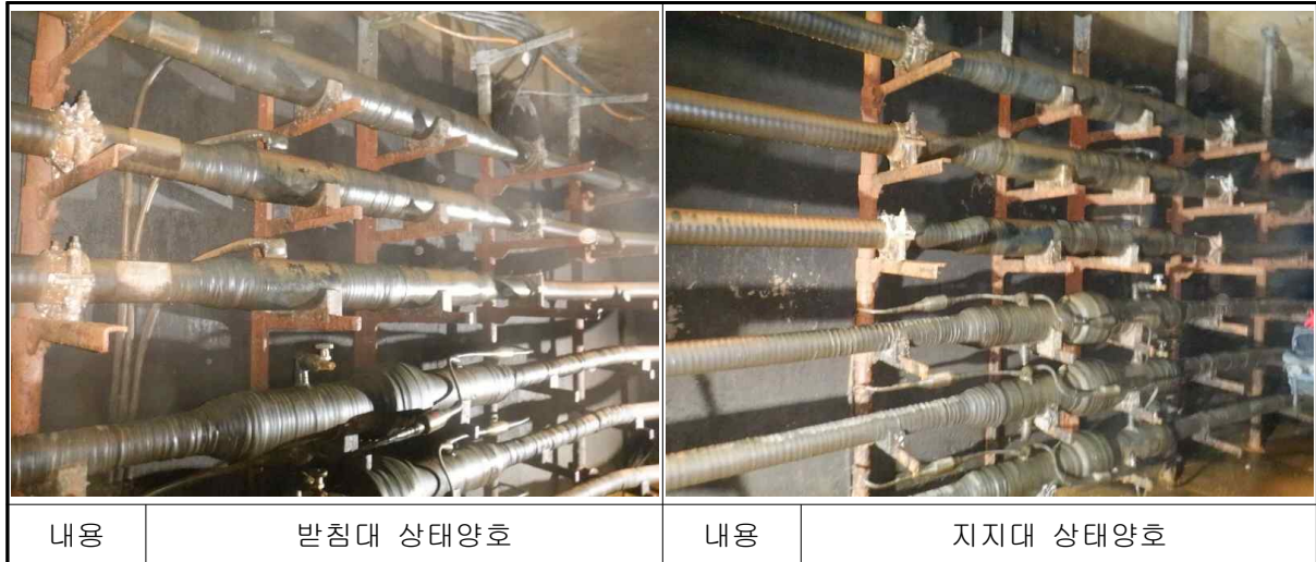
【사진 14.60】 부속 및 부대설비 현황
