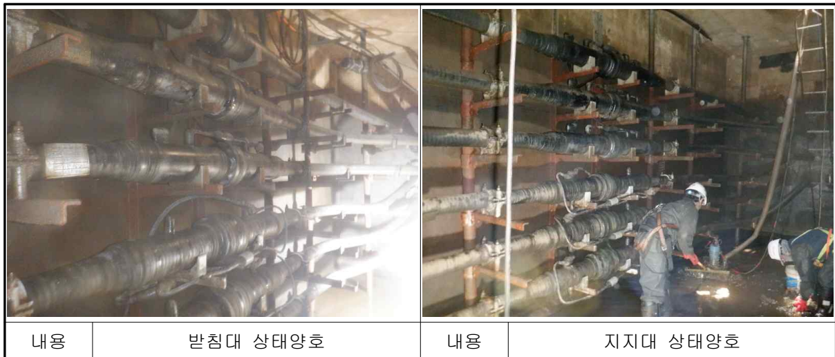
【사진 14.40】 부속 및 부대설비 현황
