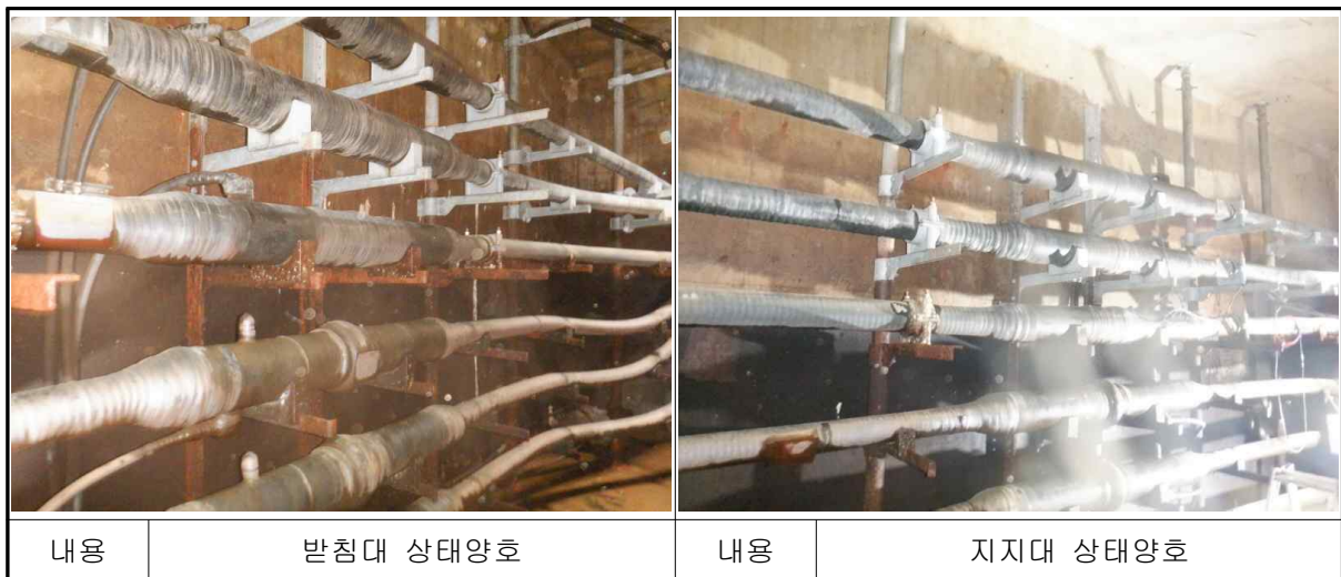
【사진 14.24】 부속 및 부대설비 현황
