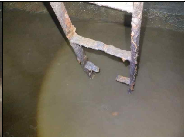
내용 일산송포#12 사다리 하부 파손
