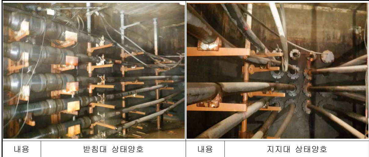
【사진 14.12】 부속 및 부대설비 현황
