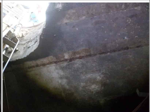
내용 상부슬래브 철근노출
